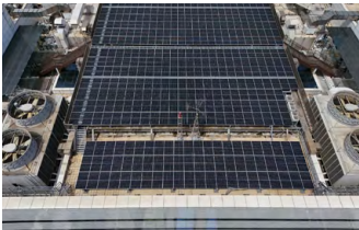
△ 台北研發總部大樓第二期太陽能板
